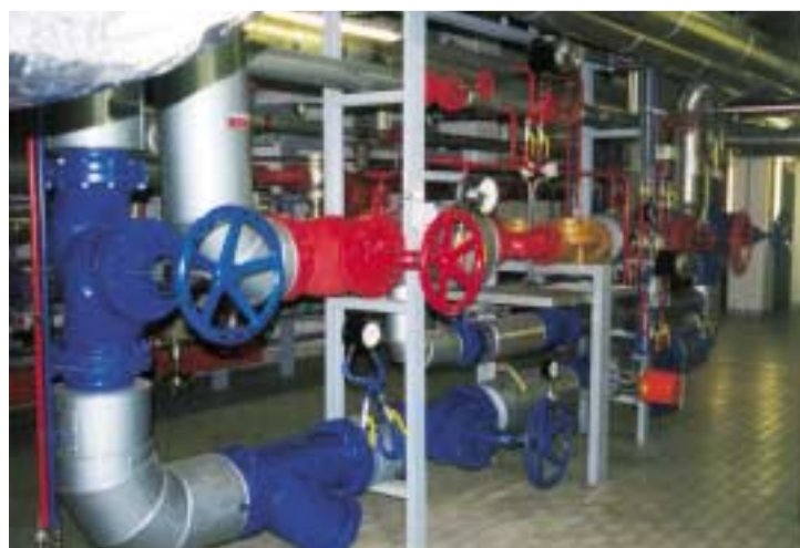
Heizstation in der Dahlemer Takustraße.
